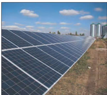
Мал. 5. Сонячна електростанція.
